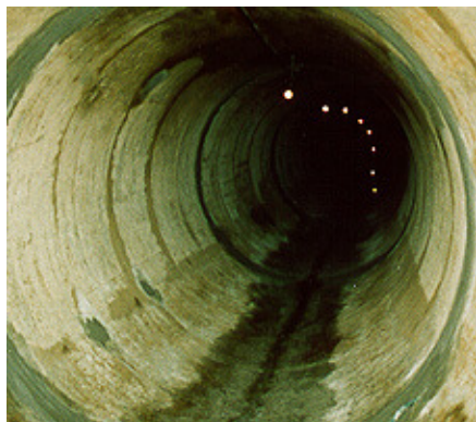
Conducto de 65 km de largo y con un diámetro de 2,5 m.
